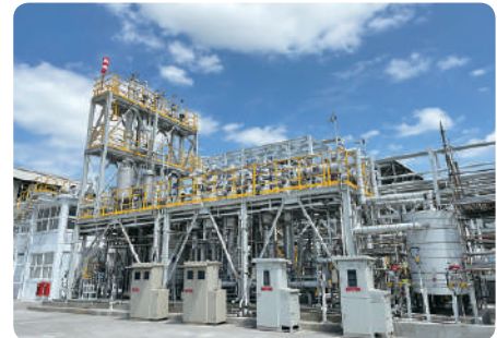
試驗工廠現場照片
